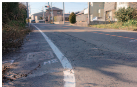
③路面に凹凸やひび割れ酷い
